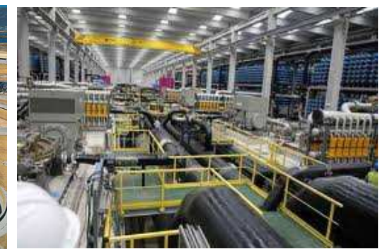
Planta desalinizadora. Prat de Llobregat
